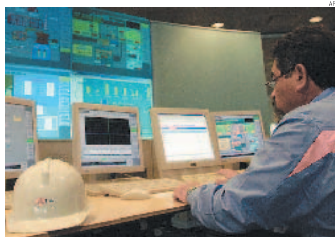
Sala di controllo. La centrale Enel di Priolo Gargallo (Siracusa)
